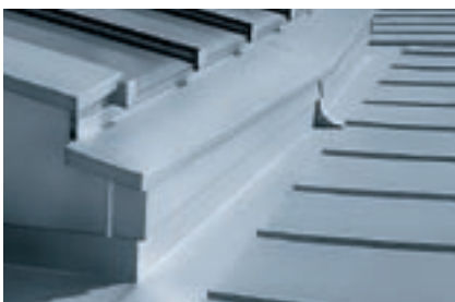
... e il raccordo posteriore delle lastre con bandella stagnata e risvolto posteriore; le lastre agganciate in questo modo possono dilatarsi liberamente.
